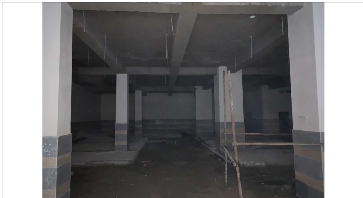
سنگ کاری و سیمانکاری دیوارها و اجرای فونداسیون دستگاه های موتورخانه مرکزی
