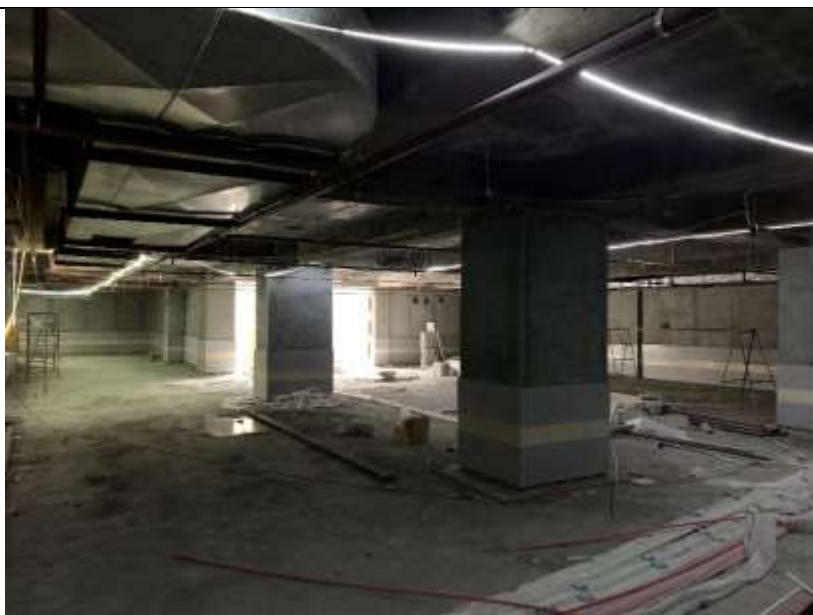
موضوع کاری: اجرای لوله اسپرینگلر و کانال هوای تازه و تخلیه دود پارکینگ ها
