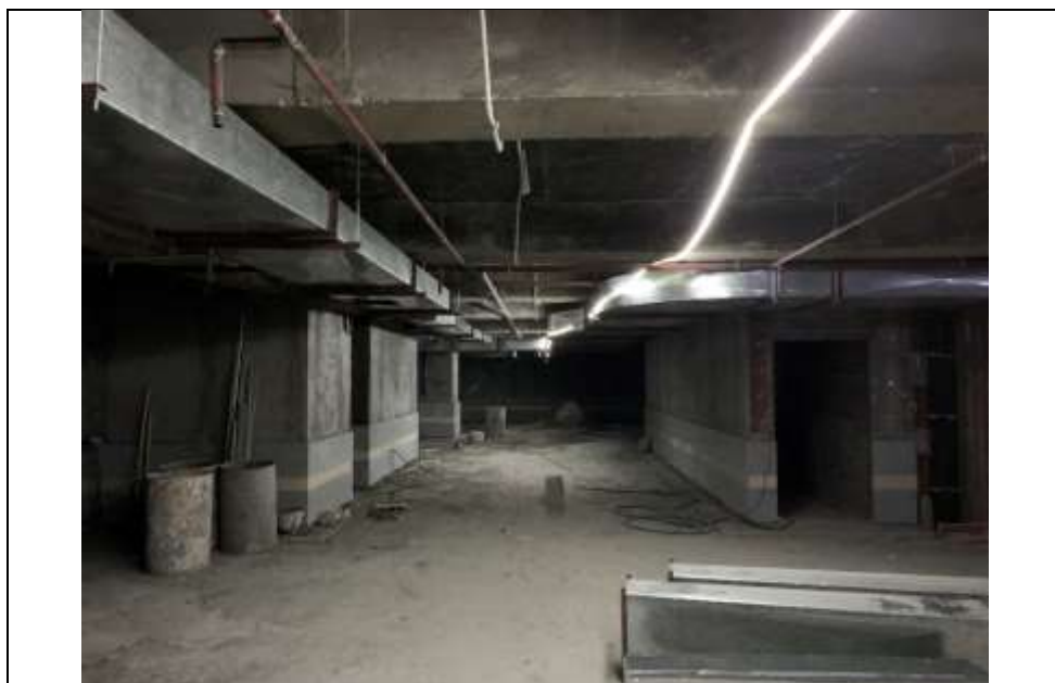
موضوع کاری: کانال نصب شده به همراه لوله اسپرینگلر در طبقه 2- بلوک B
